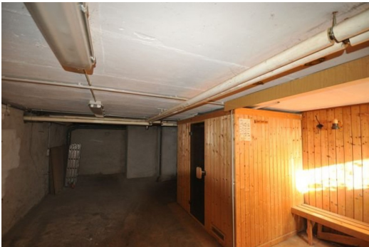
Garage u. Keller mit Sauna
