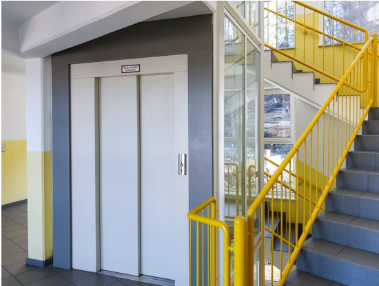
Aufzug im Haus
