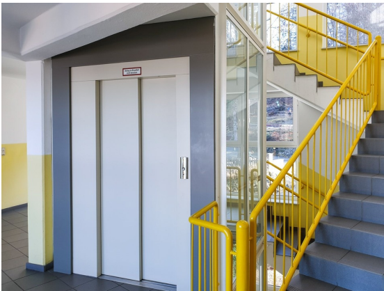
Aufzug im Haus
